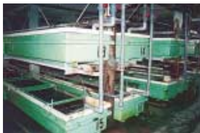
上下2段に設置された水槽
